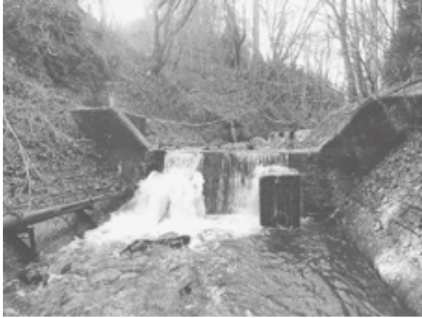
易国間地区水源地
