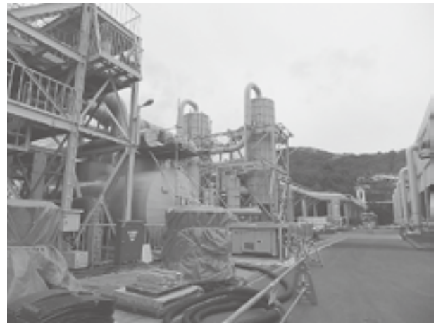
八丁原地熱発電所
