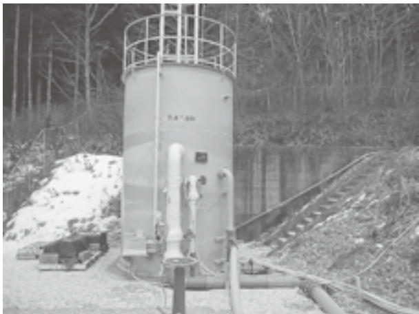
仮設の急速濾過機（易国間浄水場）
