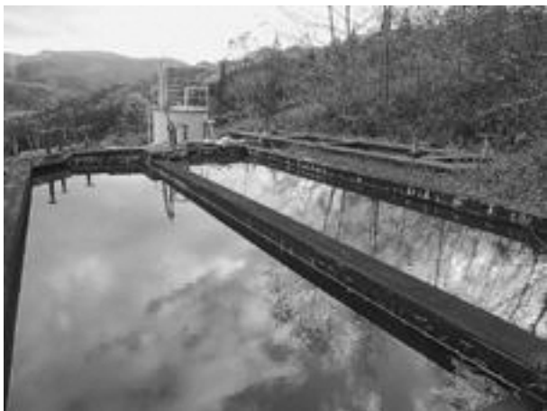
易国間浄水場（奥が急速濾過機）
