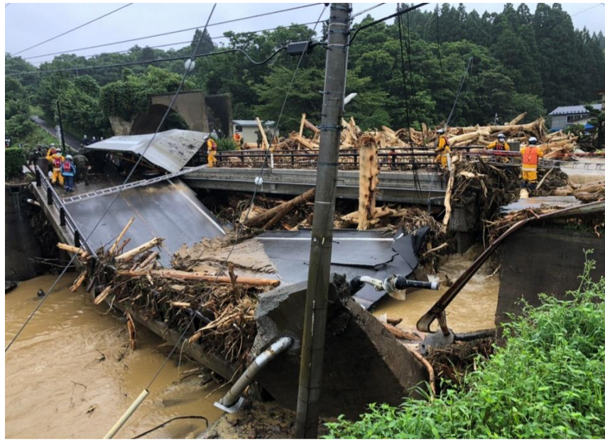
↑ 小赤川橋 (崩落)
