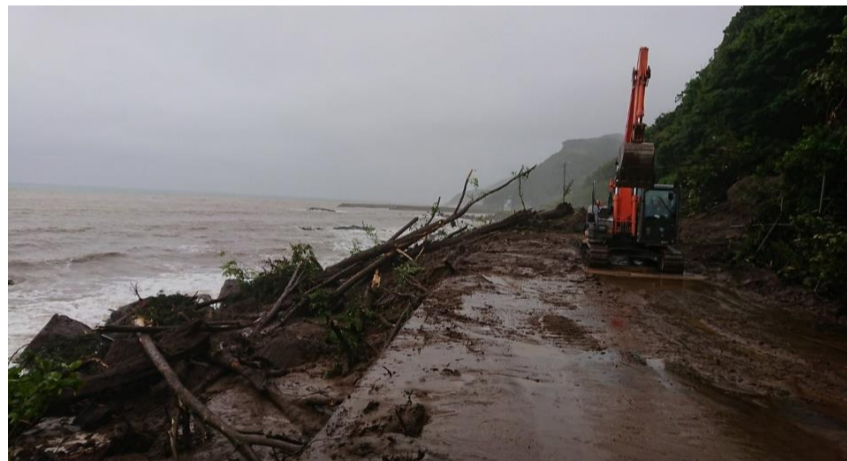
↑ 易国間～桑畑間国道 (土砂崩れ)
