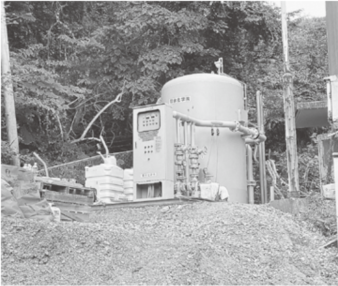
下風呂浄水場仮設急速ろ過機
