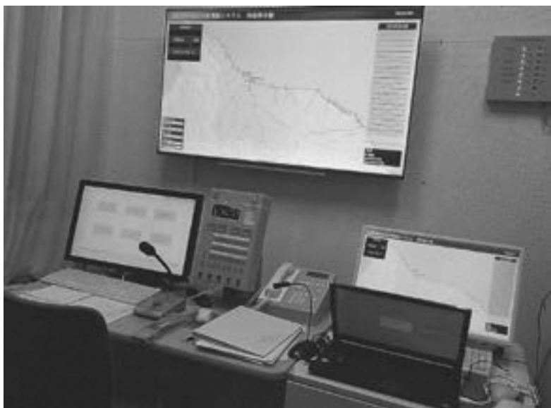
防災行政無線放送操作卓（役場庁舎内）
