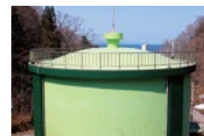
簡易水道施設
